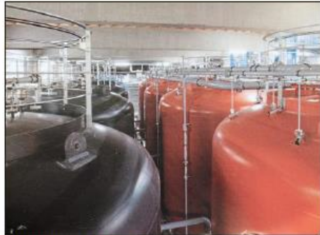
Die Enthärtungsanlage sowie Sand- und Kohlefilter sorgen für das neue weiche Waldwasser.
