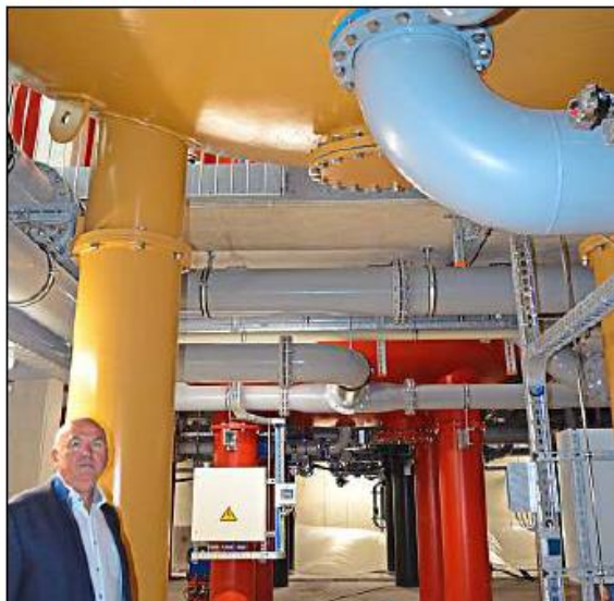
Werkleiter Hermann Gruber steht unter den Sandfiltertanks, die Eisen und Mangan aus dem Wasser entfernen.
